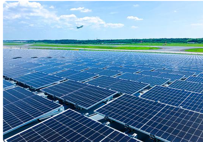
第8貨物ビル屋上に設置された太陽光パネル (2024年7月撮影)
