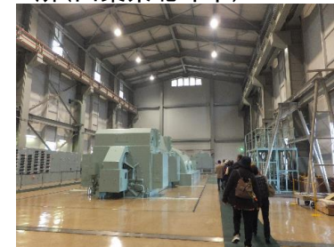
八丁原地熱発電所（大分県九重町）
