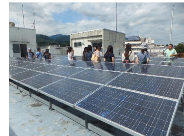
おひさま発電所（長野県飯田市）
