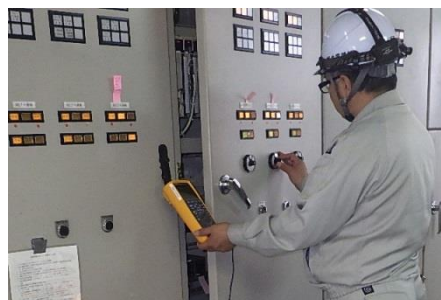
写真 6.1.1 計装設備の定期点検
