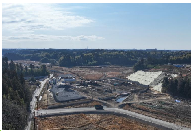
C滑走路横断道路(トンネル)整備 (地盤改良工実施中:2026年1月)
