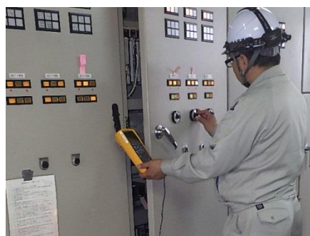
写真 6.1.1 計装設備の定期点検
