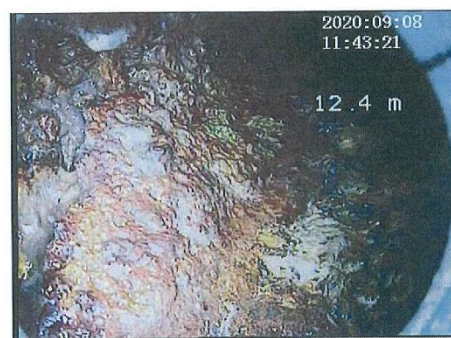
Ｂ棟 横引き管 管底部腐食（隆起）の状況
