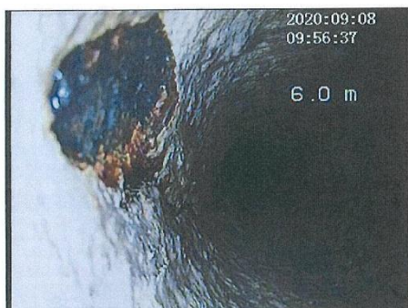
Ｂ棟 縦管（剥がれ）の状況
