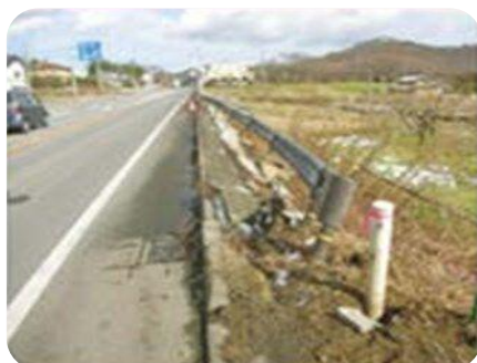
ガードレール・ 標識等の損傷
