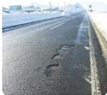
路面の穴ぼこ・ 段差
