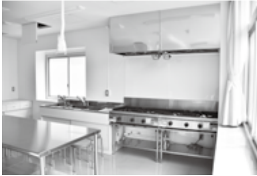
業務用高火力ガスコンロを備えた調理室
