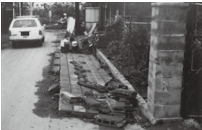
地震の揺れで倒壊したブロック塀
