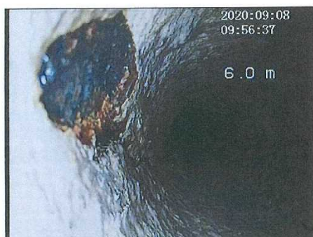
B棟 縦管 (剥がれ) の状況
