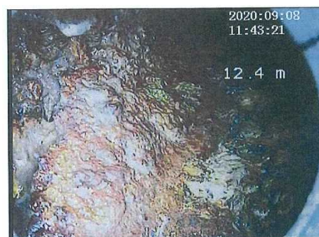
B棟 横引き管 管底部腐食 (隆起) の状況
