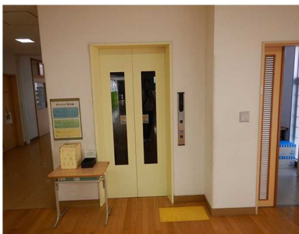
エレベーター整備による移動円滑化
