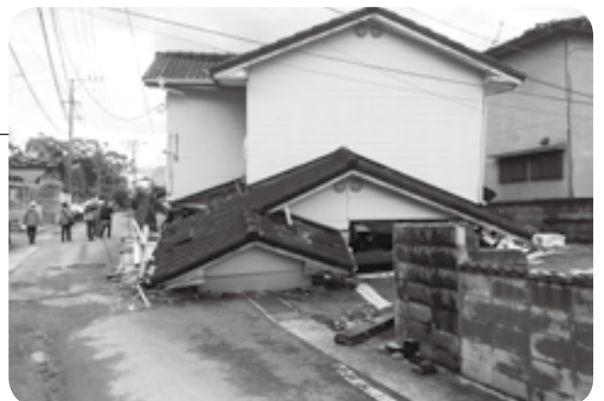
地震で倒壊した住宅
