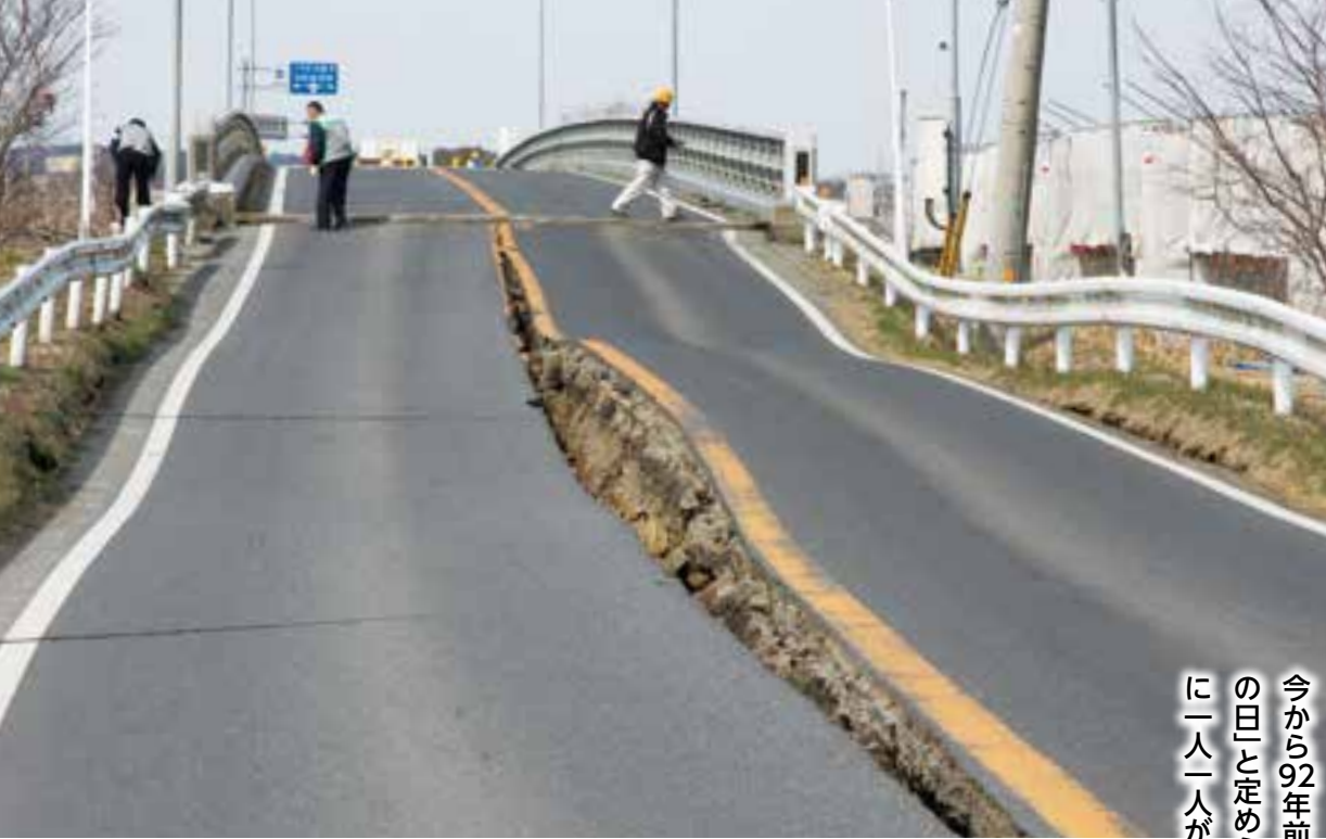
平成23年3月の東日本大震災で隆起した道路
