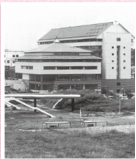
姿を現した市役所新庁舎と奥に見える旧庁舎。手前は工事中の京成成田駅東口
