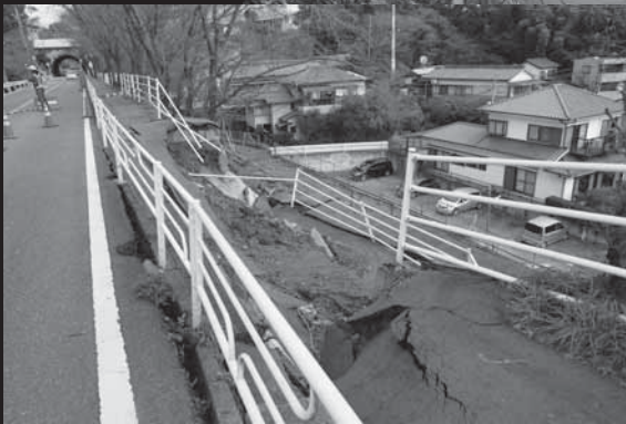
電車道の歩道が崩壊 (花崎町地先)
