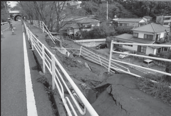
電車道の歩道が崩壊 (花崎町地先)
