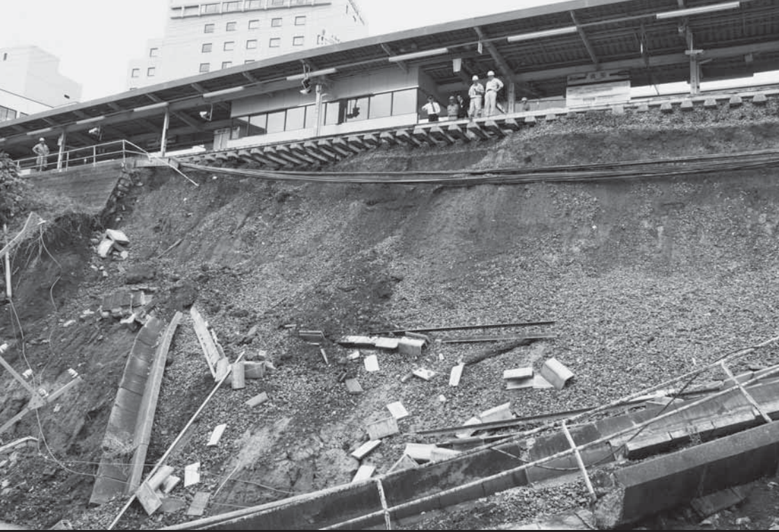
線路脇斜面の土砂が流出(京成成田駅)
