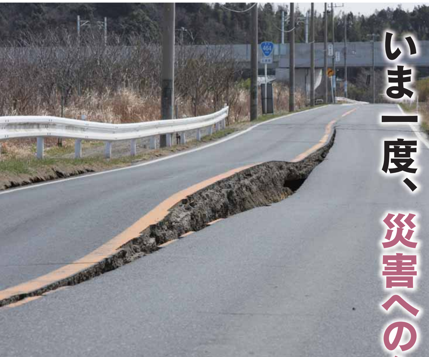
平成23年3月11日の東日本大震災による被害の様子(北須賀)
