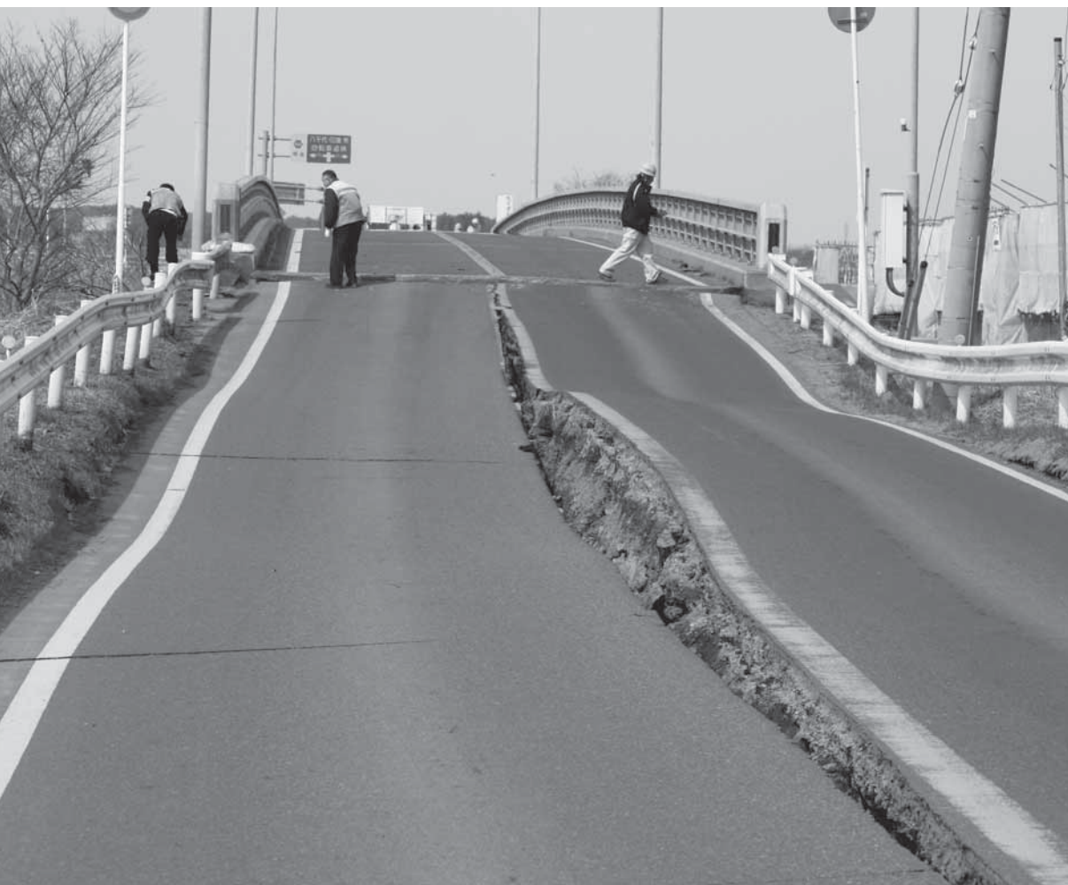
①地震により路面が大きく隆起した甚兵衛大橋
