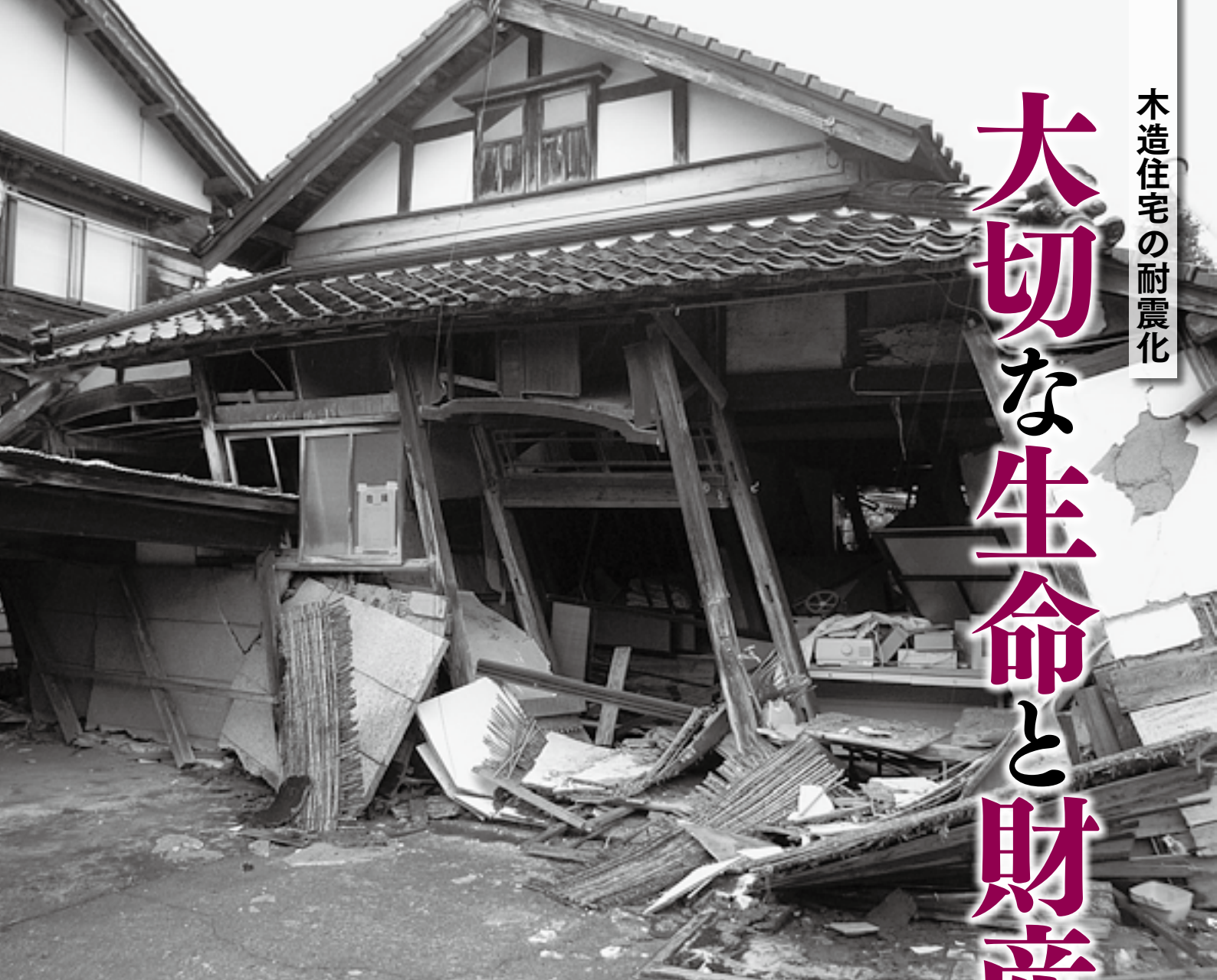
能登半島地震で倒壊した家屋(平成19年3月)
