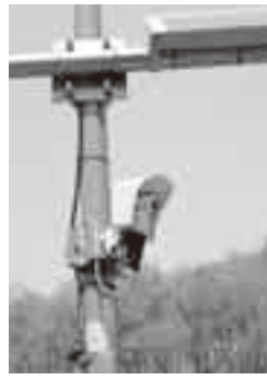
設置されているカメラ
