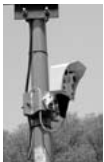
監視カメラも設置しています
