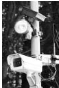
設置されているカメラ
