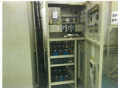
きょうたい 筐体内の設置
