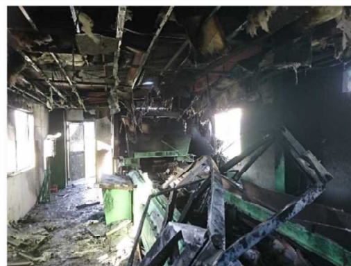
発火が原因でリサイクル工場が 焼けてしまった事例
