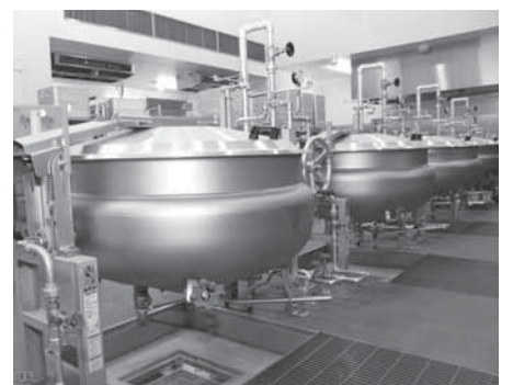
親子方式を実施する公津の杜中学校の共同調理場
