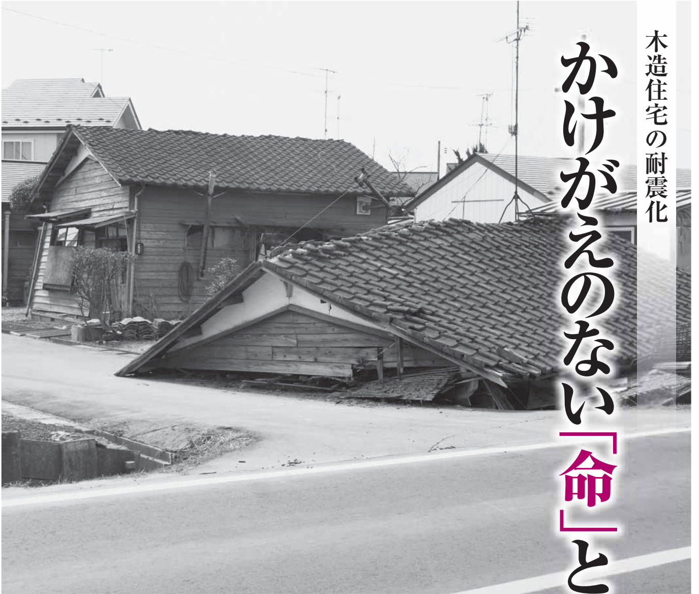
東日本大震災で倒壊した家屋(平成23年3月・宮城県大崎市提供)
