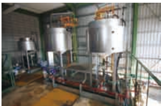
市内にある精製プラント
