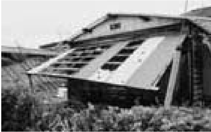
突風で被害を受けた住宅
