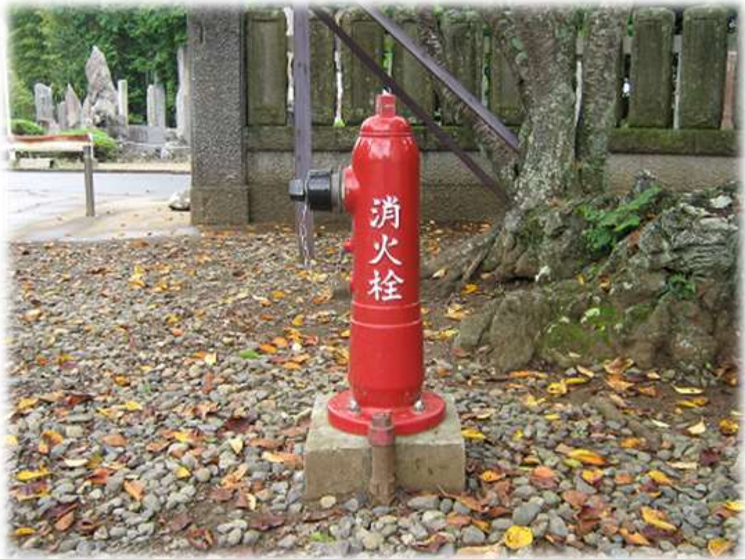
成田山新勝寺境内 立管式消火栓
