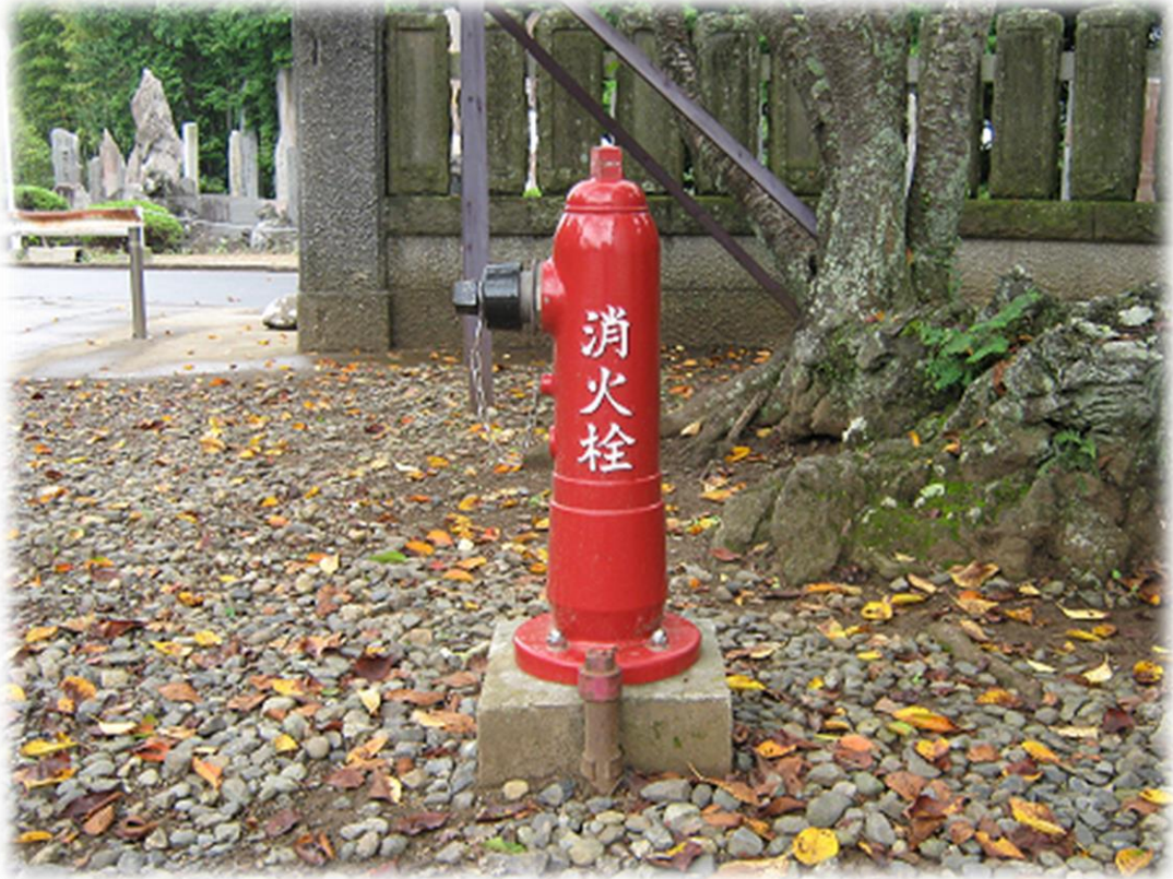
成田山新勝寺境内 立管式消火栓
