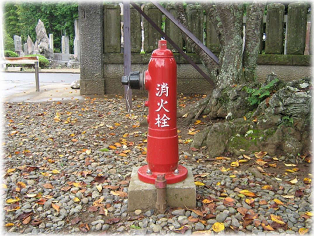
成田山新勝寺境内 立管式消火栓
