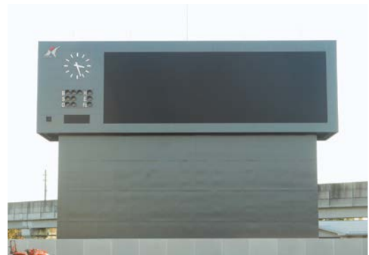
大谷津運動公園野球場のフルカラーLED式スコアボード
