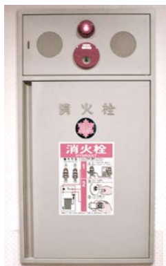
屋内消火栓設備
