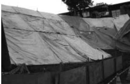
▲シートで覆われた集中豪雨による崖崩れ現場
