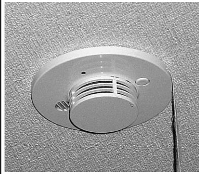
▲設置が義務化された住宅用火災警報器
