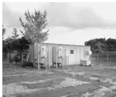
▲下総地区にある“集中処理浄化槽”
