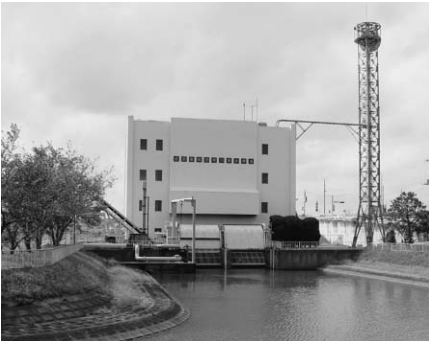
▲派川根木名川の排水機場
